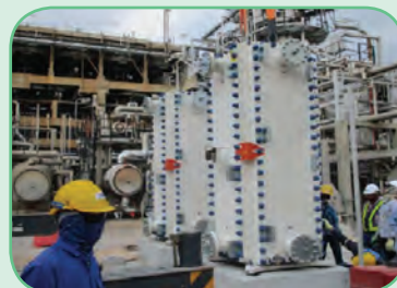
การติดตั้งเครื่องแลกเปลี่ยนความร้อนแบบแผ่น (Plate heat exchanger) ที่ บริษัท ไทยลูบเบส จำกัด (มหาชน)
